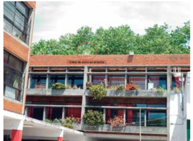
Figura 5. Colas de zorro en el techo de la escuela.
